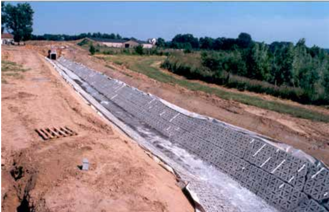
Fig 5: 'Natuurtechnisch' aangelegde langssloot naast de N-37 met gegoten betonnen bodem. Het dijktaflood rechts in beeld herbergt de populatie Reuzenpaardestaart. Zicht naar het Oosten van de NO-hoek van het gebied. Bemerk op de achtergrond ook de nieuwe waterproductieinstallatie (foto dd. 25 VI '01).
