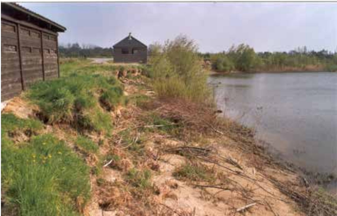
Fig 3: Oevererosie op de oostelijke oever ten noorden van het waterinnamepunt. Bemerkt dat de fundamente van de kijkhut reeds bereikt zijn en dat aan de (wel verdedigde) oever ter hoogte van het innamepunt goed te zien is dat de oever reeds ver is teruggeschreden (foto dd. 10 IV '02)
